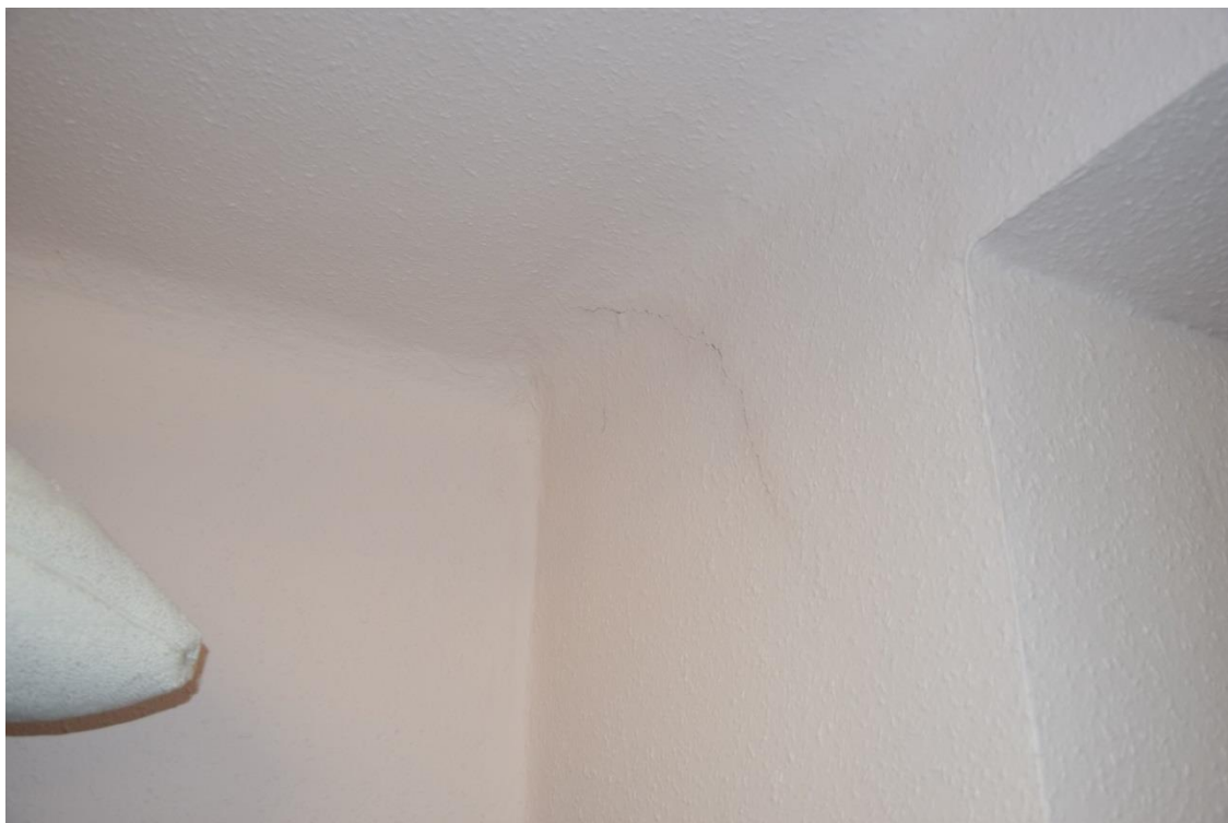
6. ábra: Hajszálrepedés indul a fal-födém kapcsolattól a tűzfalra merőleges falon a galéria szinten.
