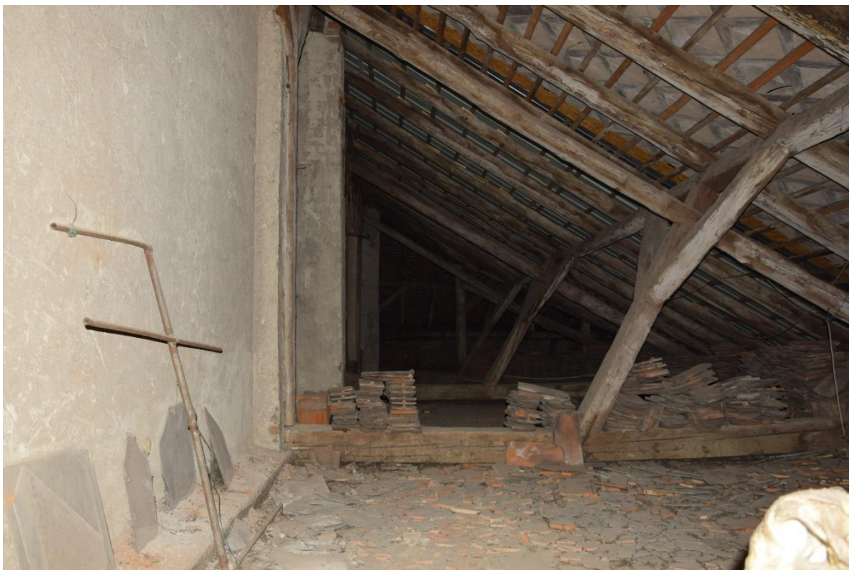
2. ábra: A fedélszék szerkezeti kialakítása a szomszéd felőli oldalon.
