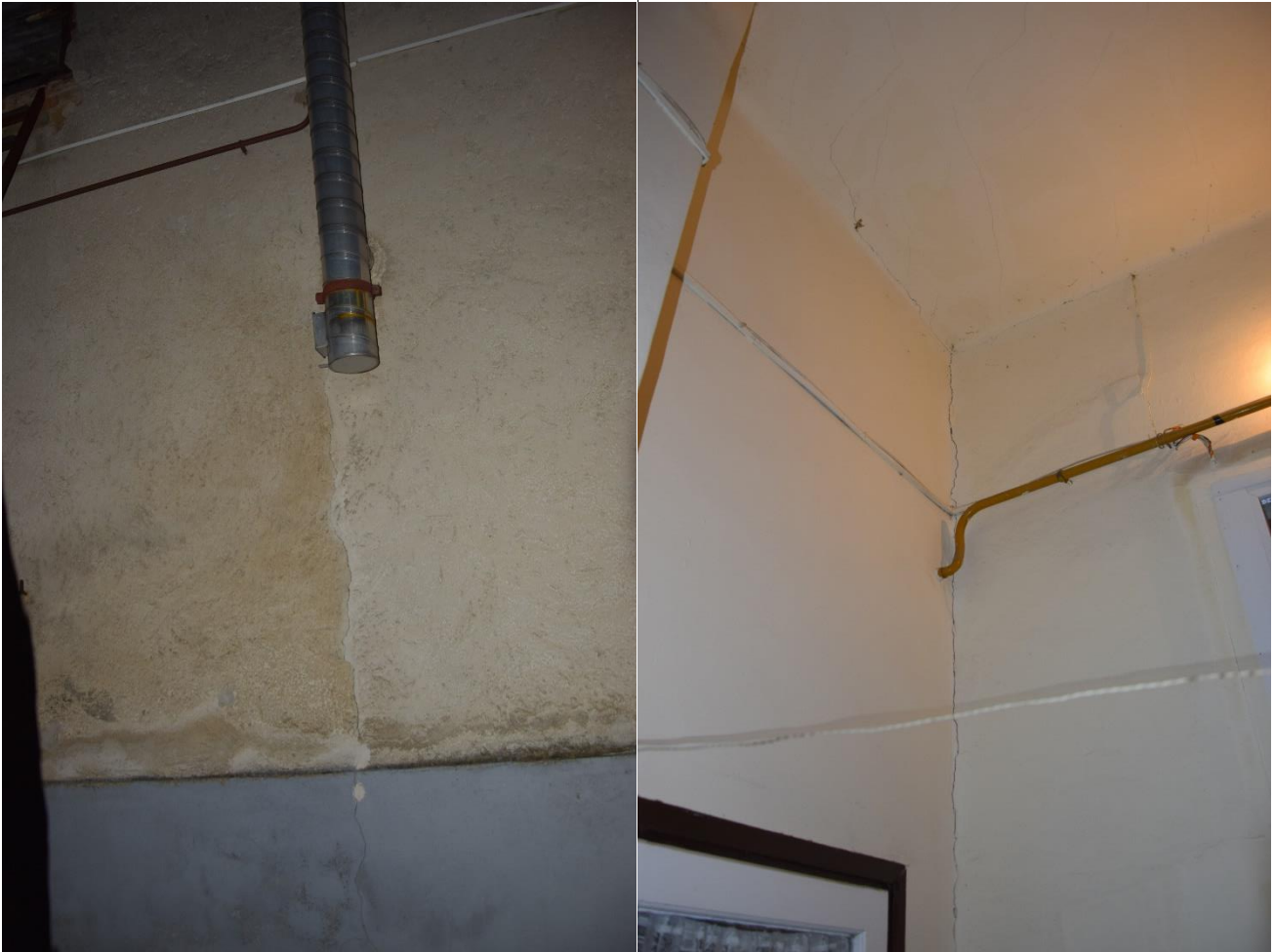
12. ábra: Régi és új falazat határán létrejövő függőleges repedések (tornác beépítés).
