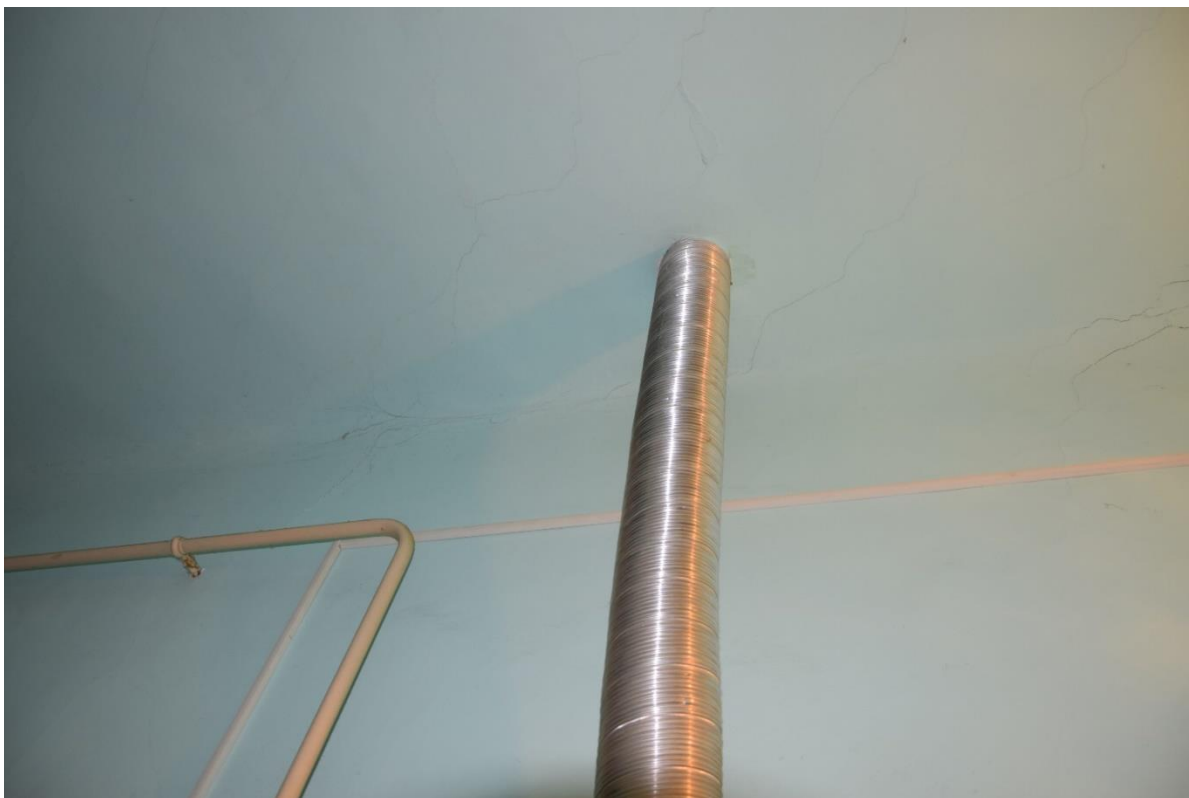
19. ábra: Födémén kialakuló repedések.
