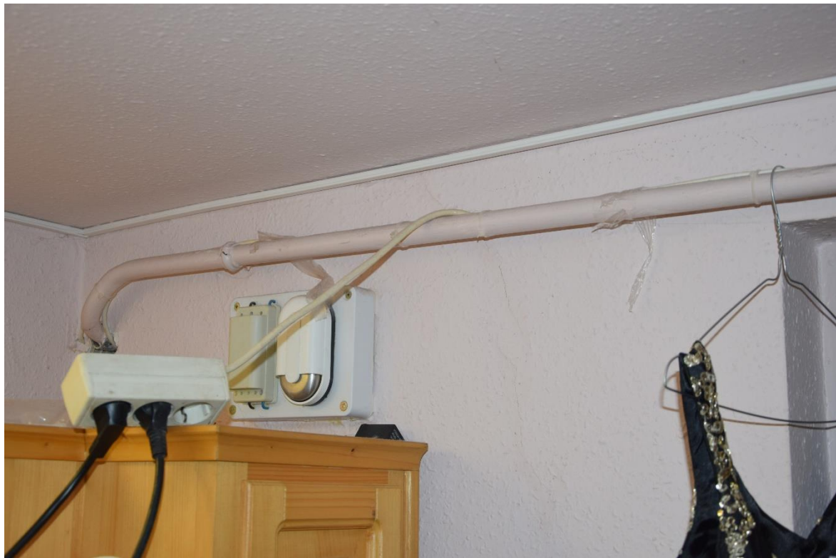
10. ábra: Hajszálrepedés indul a fal-födém kapcsolatból a galéria szinten.
