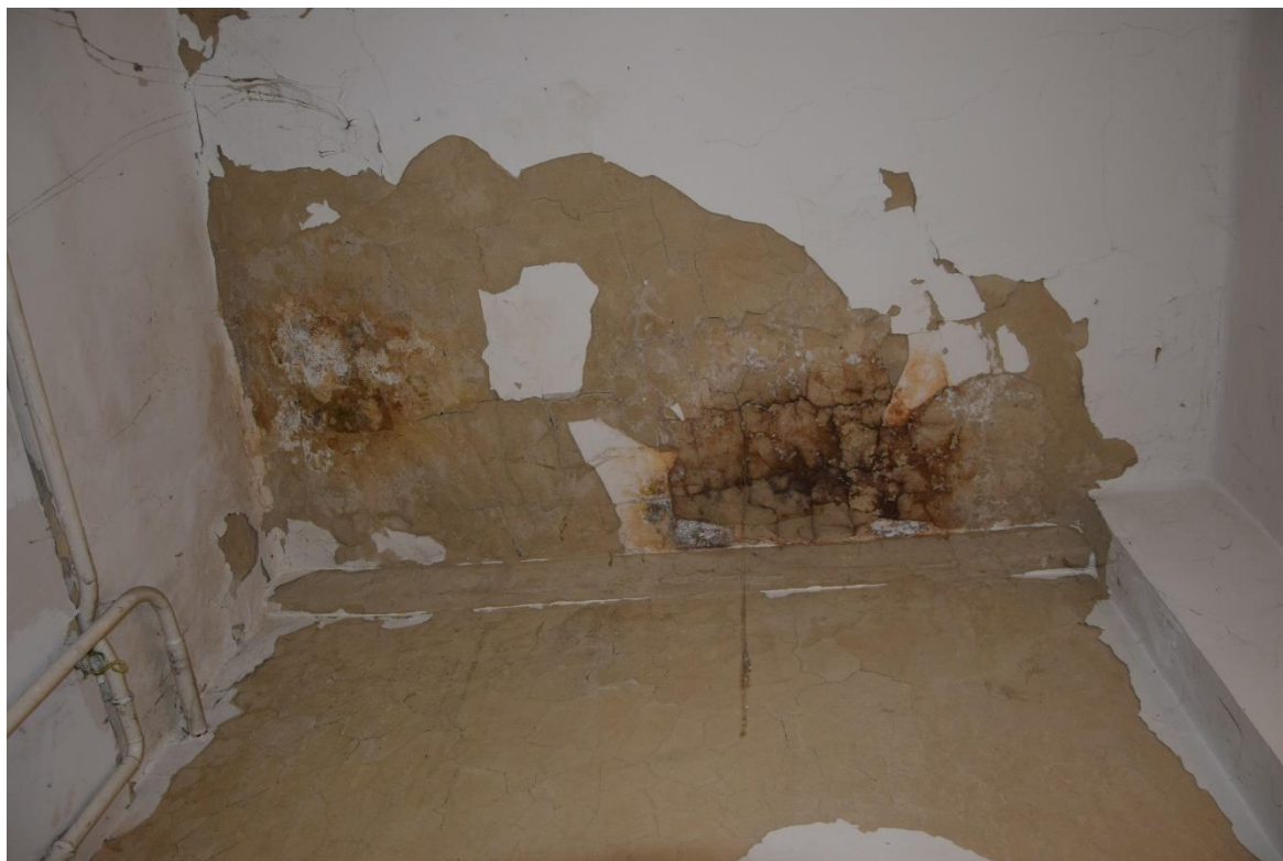
13. ábra: Beázások a tető és eresz kapcsolatnál a födémén.
