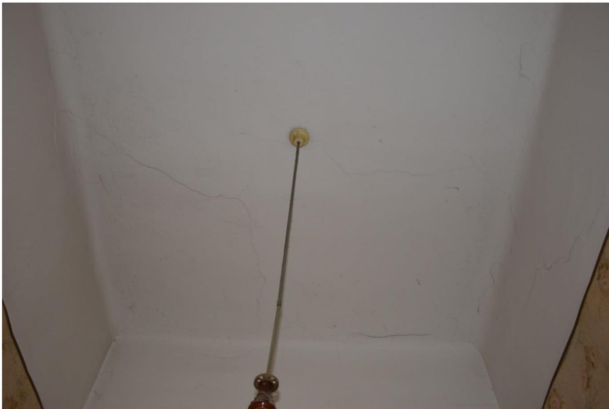
14. ábra: Födémén végigfutó repedések.
