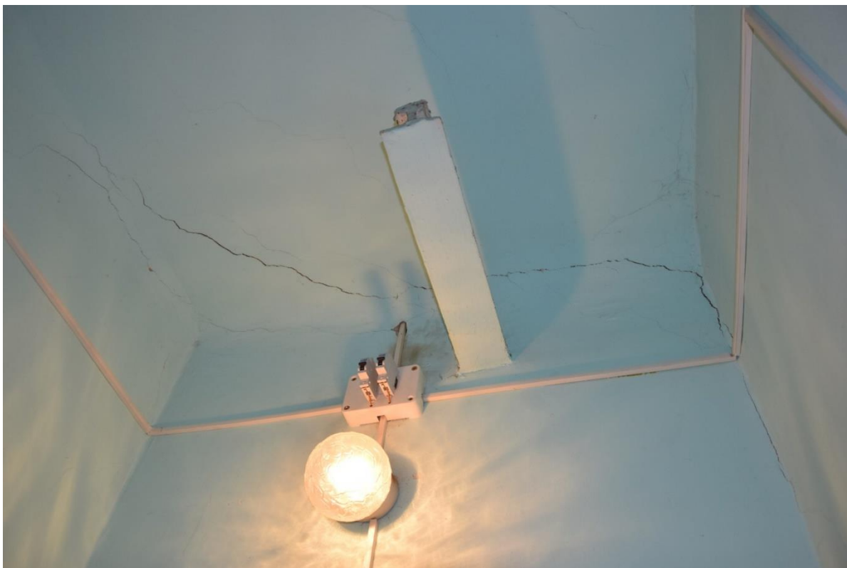
17. ábra: A szomszédos épület felőli tűzfal süllyedéséből származó repedés (becsült repedéstágasság ~0.5 cm).
