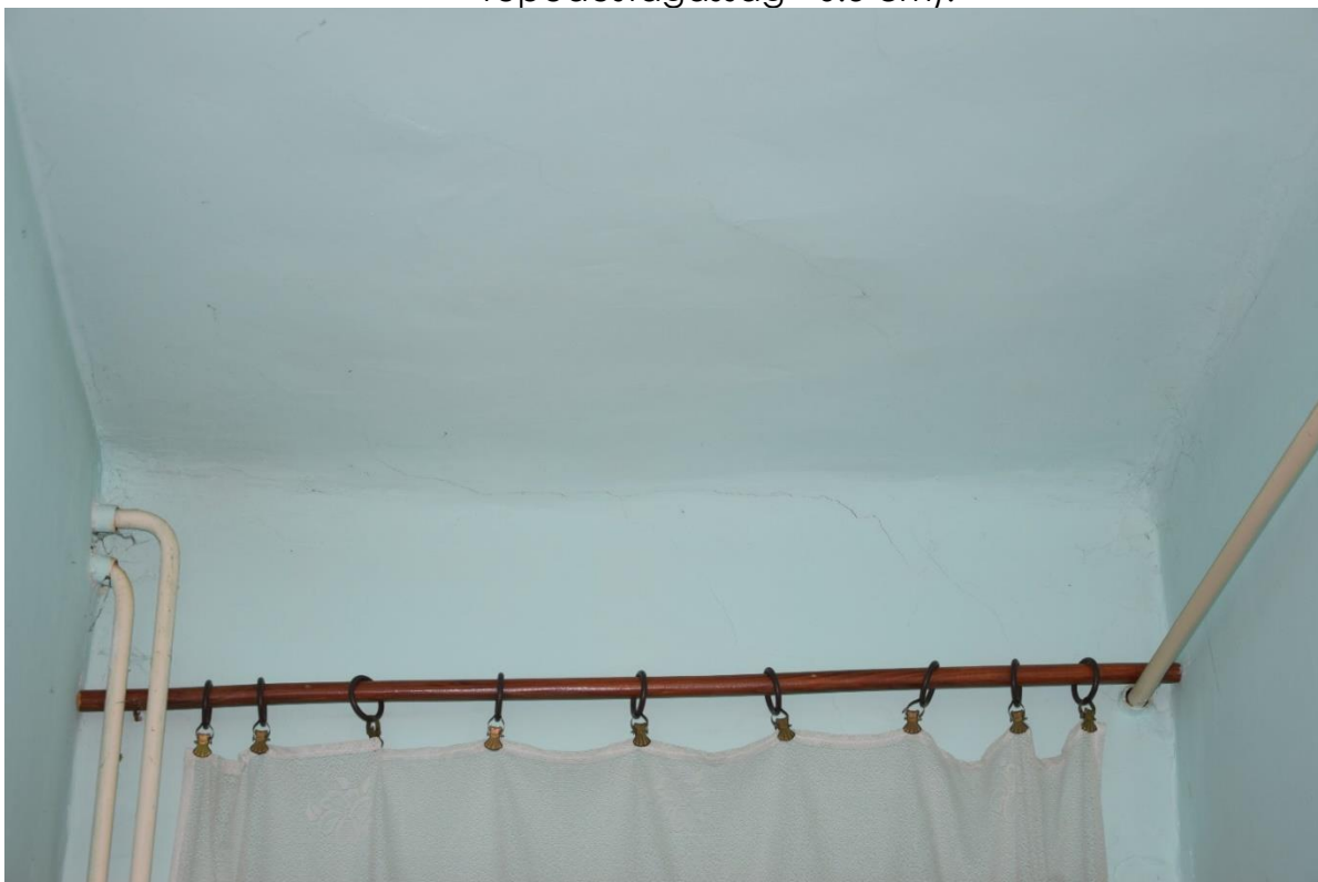
18. ábra: Vízszintes repedés a födém-fal csatlakozásnál, majd diagonális repedés a falban.
