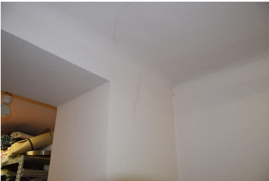
5. ábra: Hajszálrepedés a tűzfalra merőleges falon a galéria szinten.
